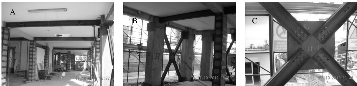
Fig. 10 – A) Collegamento telai – B) Vista di un triplice intervento – C) Particolare controvento
