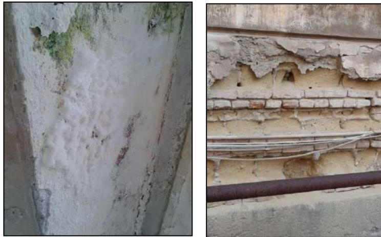
A sinistra la cristallizzazione salina superficiale; a destra la disgregazione superficiale dei blocchi di tufo di Palazzo d'Avalos a Napoli
