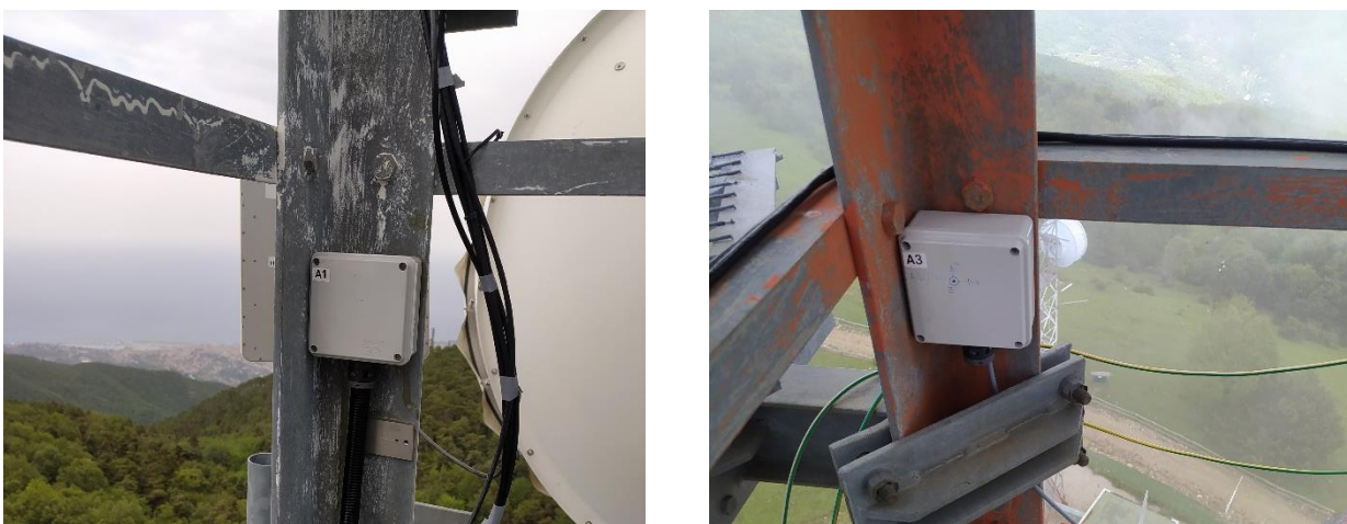
Figura 3 – Esempio installazione accelerometri A1 e A3
