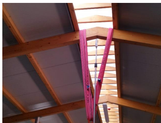
Applicazione del carico su trave in legno lamellare di una copertura inclinata
