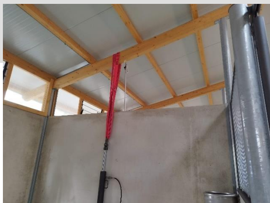
Applicazione del carico su trave in legno lamellare di una copertura inclinata
