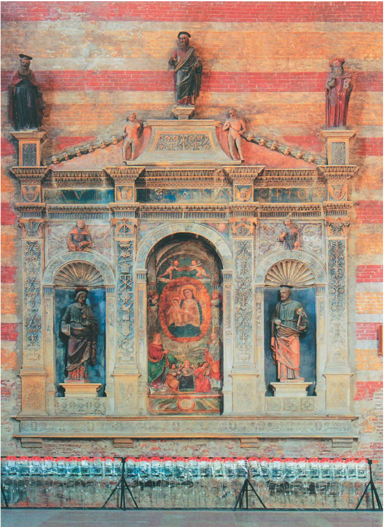
Madonna con bambino e decorazioni affrescate di Stefano da ferrara; architettura e statue di Bonino de Campione (XIV secolo). Realizzazione della barriera idrofobizzante con formulato specifico TRF 135 alla base dell'Altare Ave Regina Caelorum.
