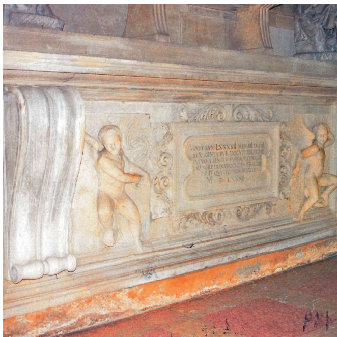
Altare del Mantua Benavides interessato da umidità ascendente non perforabile. L'idrofobizzazione è stata attuata con la "tecnica del sottovuoto dinamico". (Fasi di intervento allegate)
