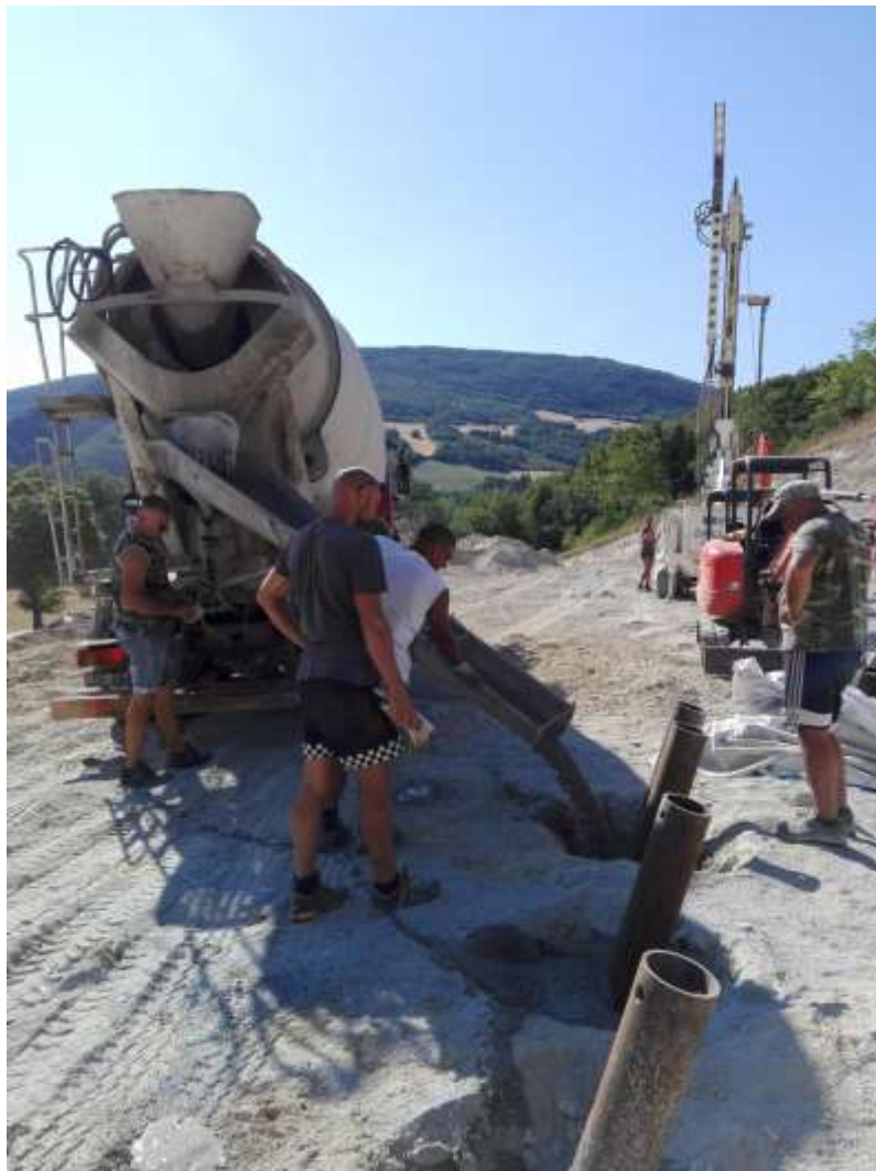
Figura 3 – Esecuzione di perforazioni verticali o sub-orizzontali all'interno delle quali vengono posati tubi d'armatura o profilati gettati in opera con miscela cementizia per consolidamento dei terreni.
