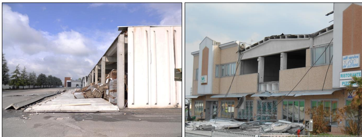
A sinistra ribaltamento dei pannelli di tamponamento verticali, a destra ribaltamento dei pannelli di tamponamento orizzontali (Emilia 2012)
