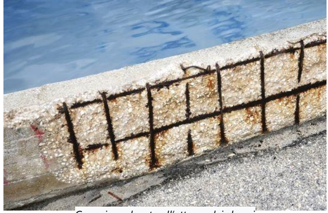
Corrosione dovuta all'attacco dei cloruri
