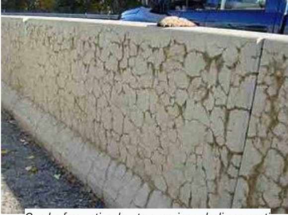
Quadro fessurativo dovuto a reazione alcali aggregati
