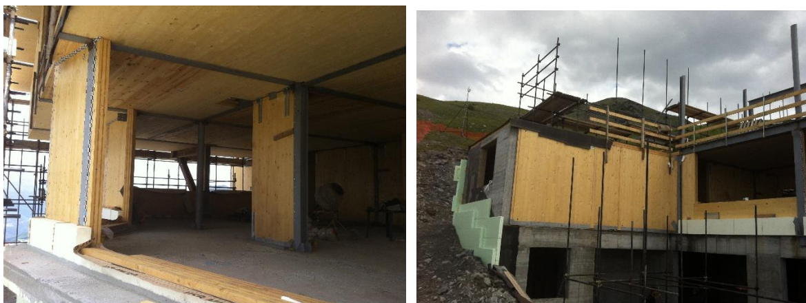
Pareti in cemento armato, in X-Lam e colonne in acciaio connessi tra loro
