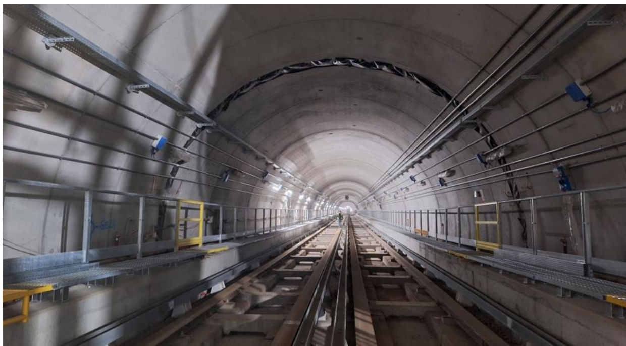
Fig 1. In corrispondenza del giunto dielettrico sono state messe in opera passerelle pedonali in PRFV appositamente di colore giallo.
