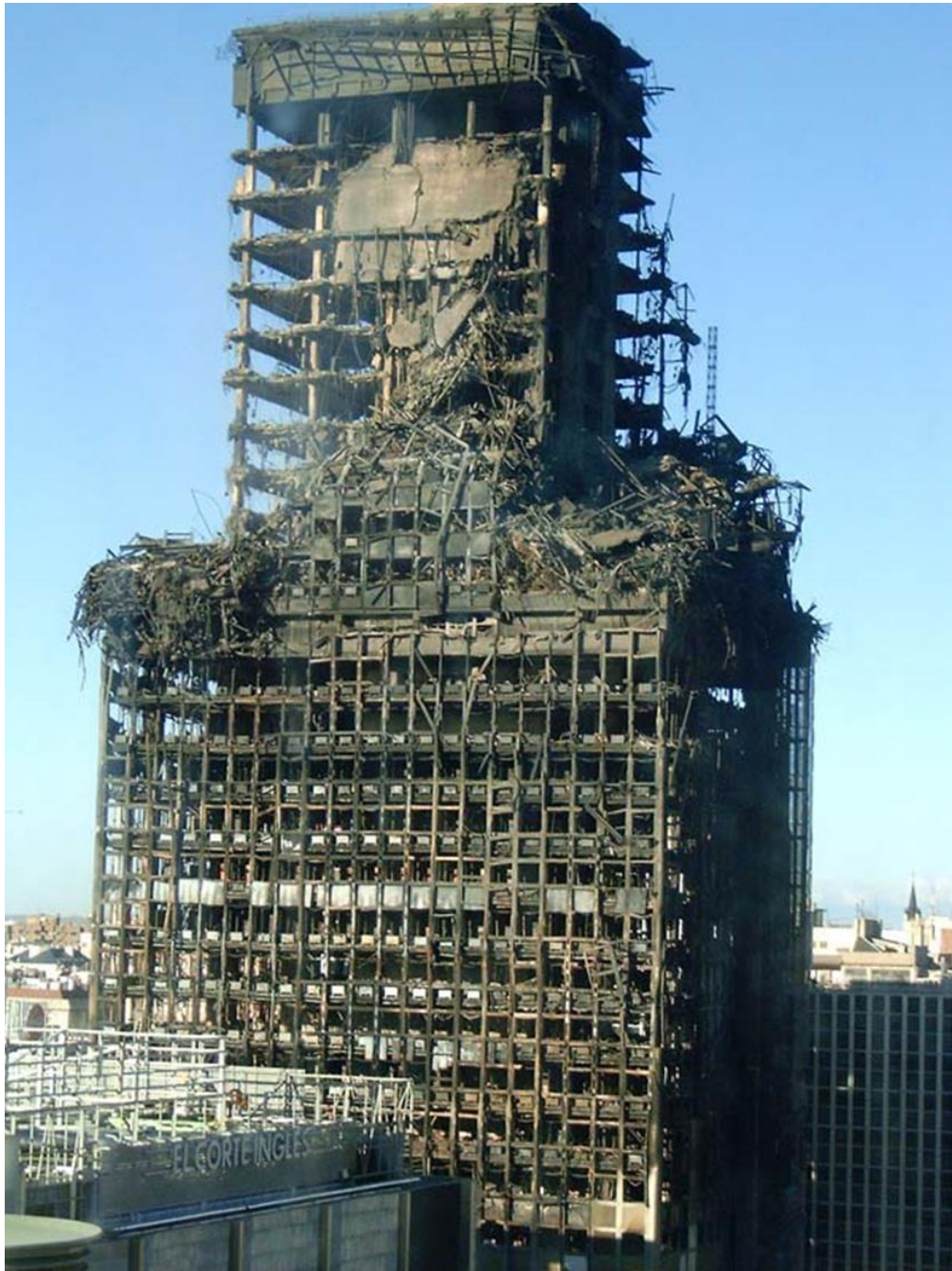
Figura 10 – Arresto del collasso progressivo dei piani superiori dell’Hotel Windsor a Madrid per la presenza di un irrobustimento legato ad un piano tecnico [8].
