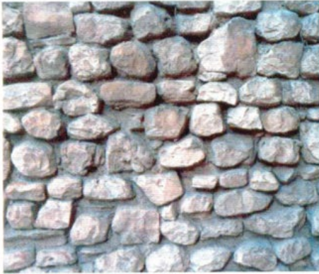
Fig. 1 - Muratura in pietraforte fortemente degradata per erosione e decoesione dei giunti di malta. Il degrado avanzato delle malte può provocare il distacco dei blocchi lapidei con instabilizzazione e caduta degli stessi.
