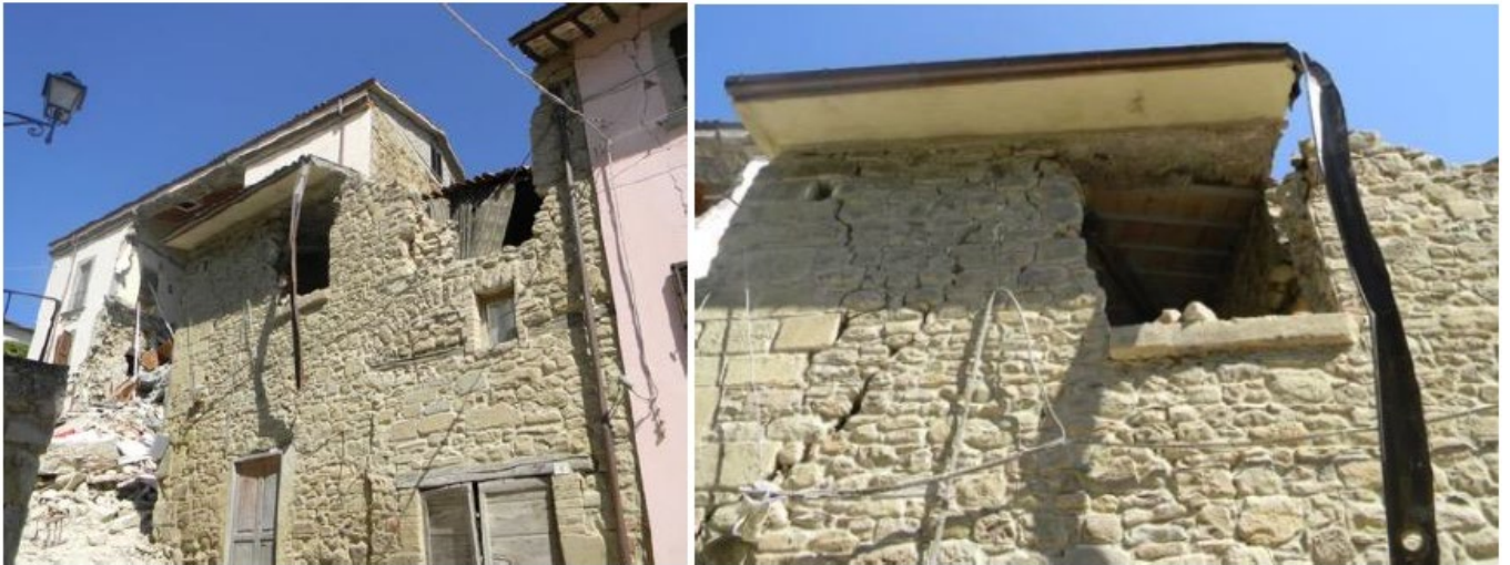
Fig. 10. Disgregazione di un edificio in muratura (da [3])
