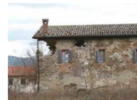
Figura 2 – Edificio a Camerino danneggiato dalla sequenza sismica iniziata il 24 agosto 2016
