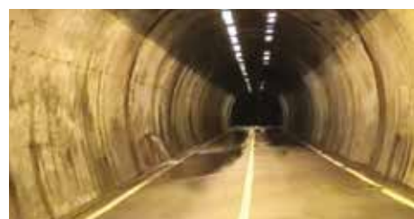
Importanti venute d'acqua in galleria
