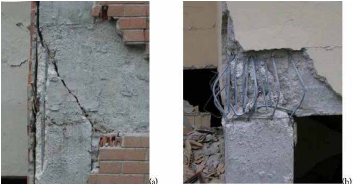
Figura 1 – Crisi nei nodi in edifici in Abruzzo 2009 per (a) resistenza a trazione (b) instabilità delle barre
