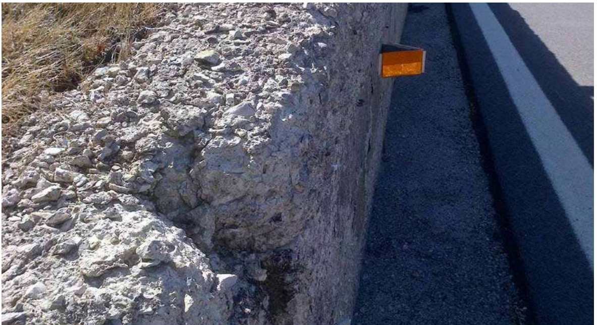
Figura 1 – Degrado del calcestruzzo per cicli di gelo-disgelo
