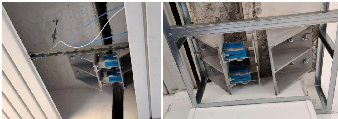
Installazione dispositivi SismoBox: Configurazione A (sinistra) e Configurazione B (destra)
