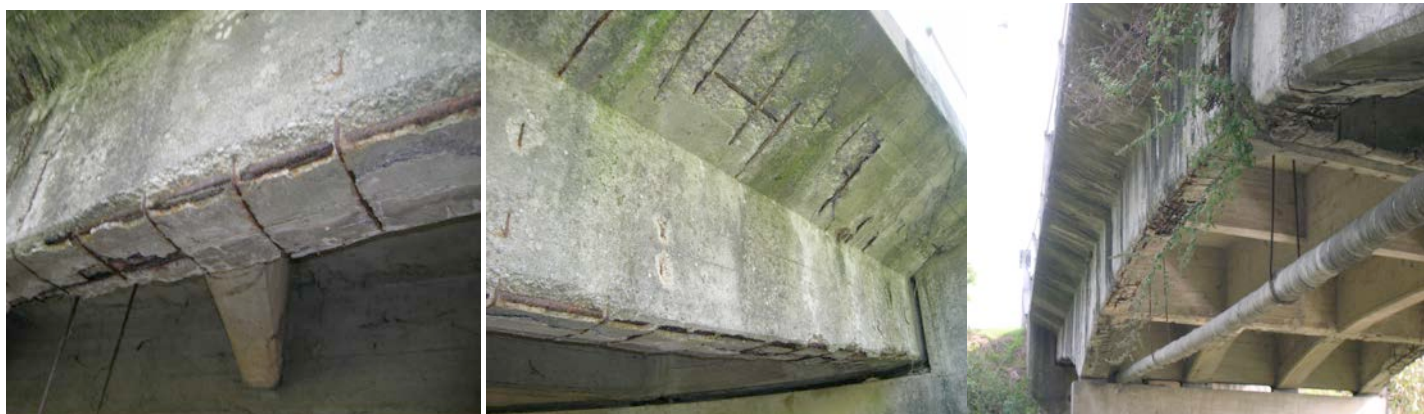
Ponte inagibile per evidente degrado del calcestruzzo e delle armature.
