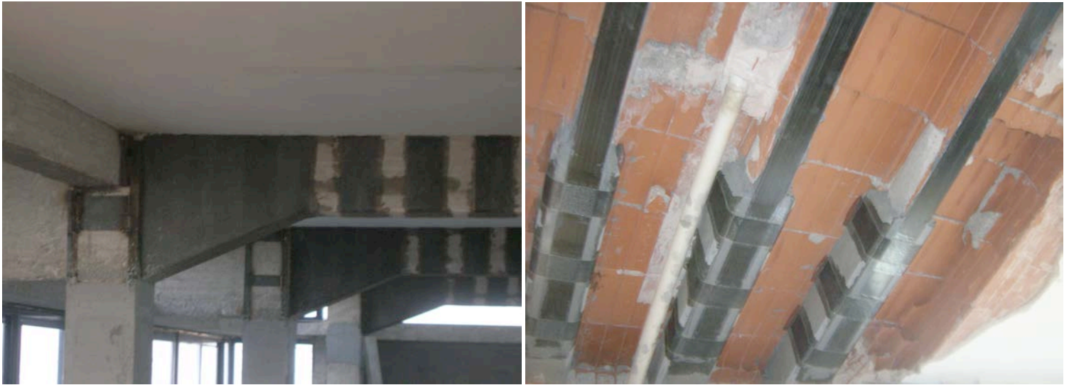
A SINISTRA: Rinforzi a taglio. A DESTRA: Rinforzi taglio flessione di solaio in latero cemento.
