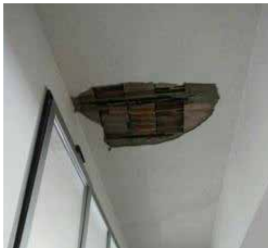
Figura 1. Fenomeno di “sfondellamento” di solaio in latero-cemento gettato in opera
