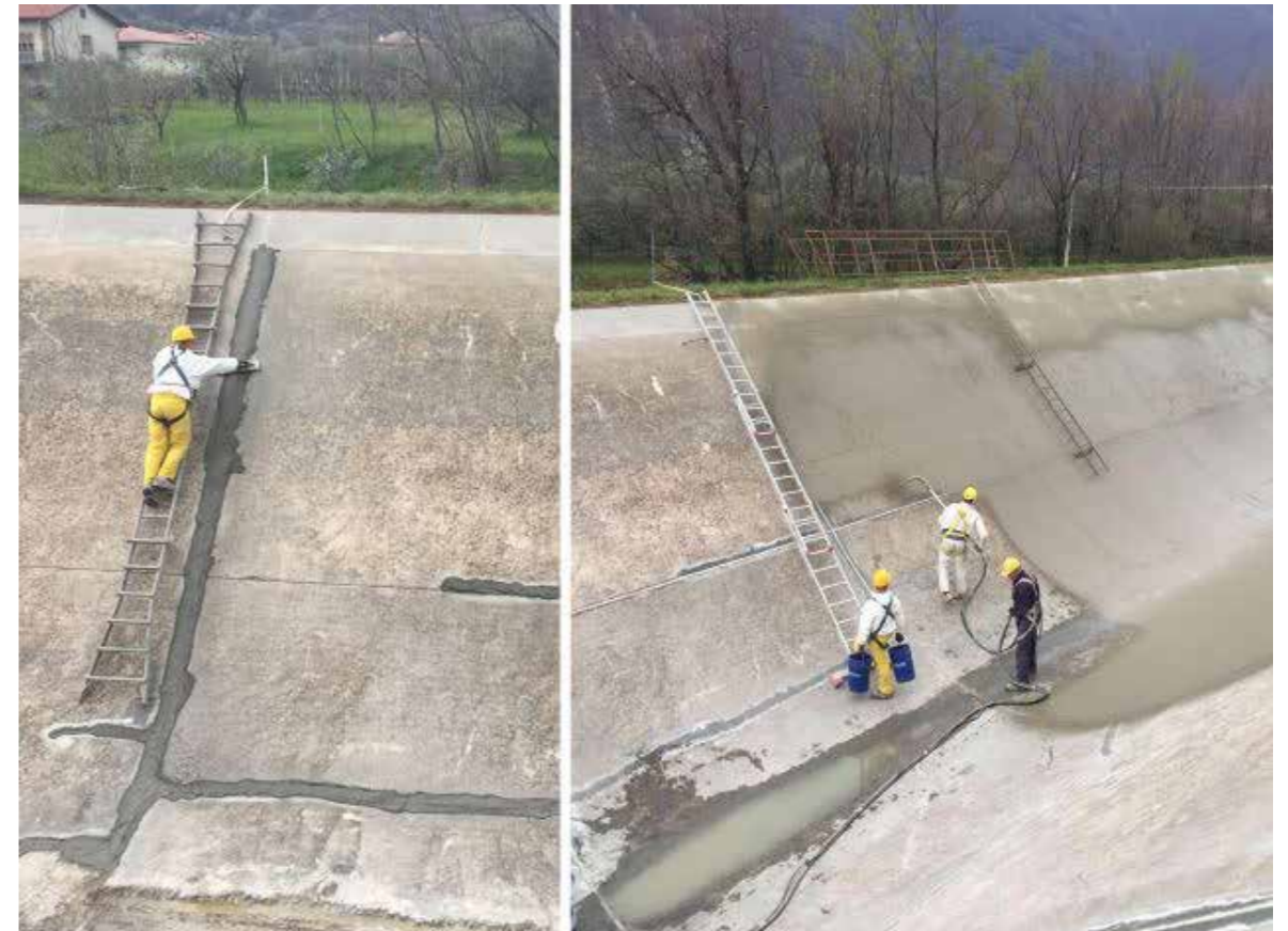
Canale Barbizza, ENEL GREEN POWER, Bassano Del Grappa
