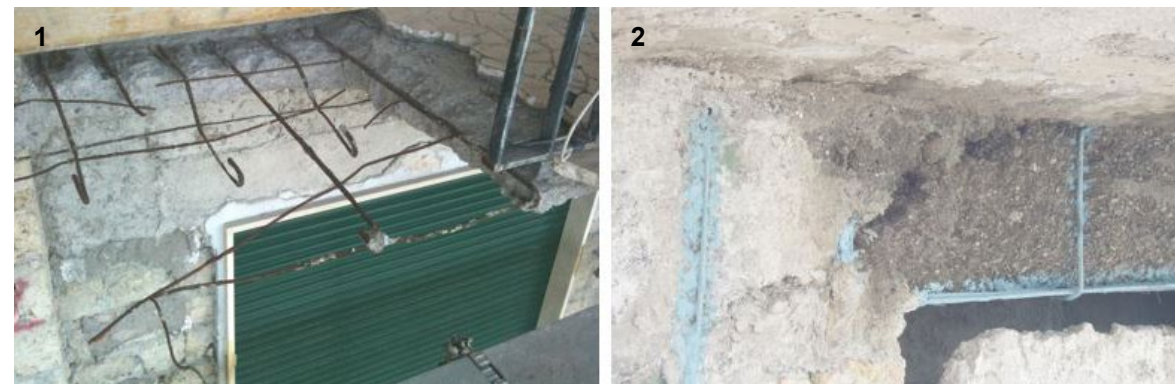
Foto 1. Crollo parziale di una soletta a sbalzo all'atto della rimozione del pavimento
