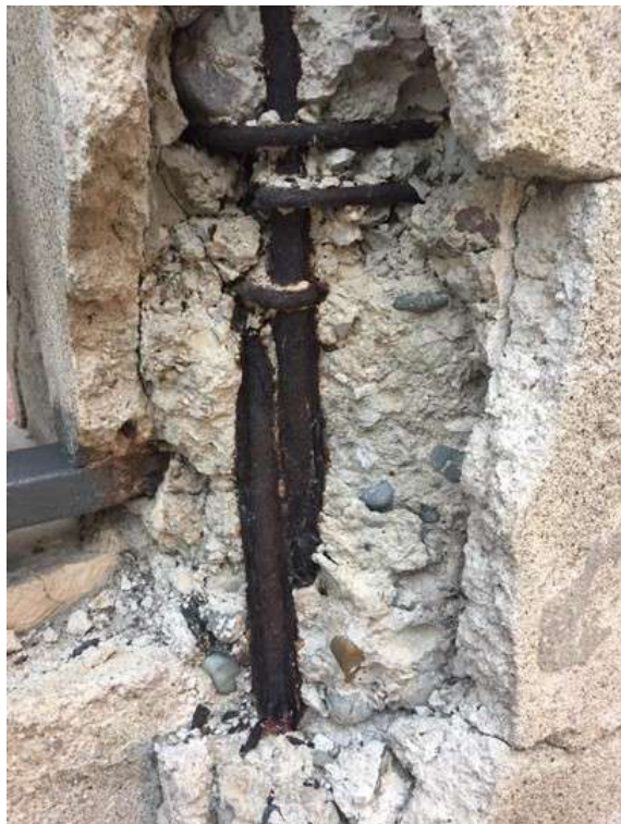
Esempio di corrosione promossa da carbonatazione
