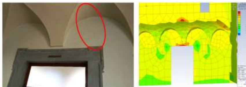
Figura 31: Esempio di corrispondenza tra fessurazione rilevata in situ e ottenuta dal modello matematico.
