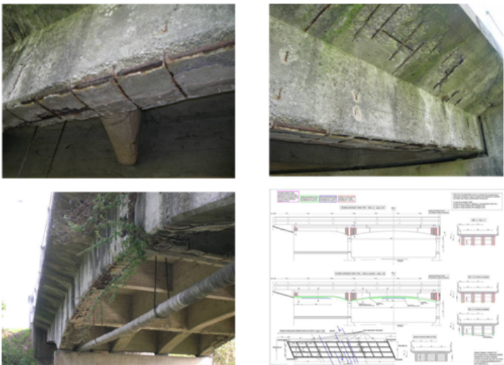
Fig. a: ponte inagibile per evidente degrado del calcestruzzo e delle armature
