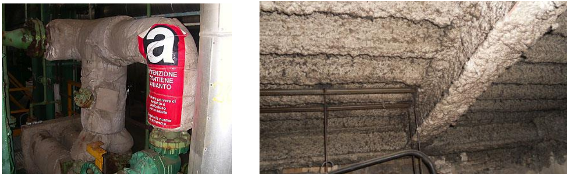
Figura 8, 9 – Esempi dei principali usi di amianto friabile nel settore dei materiali da costruzione.
