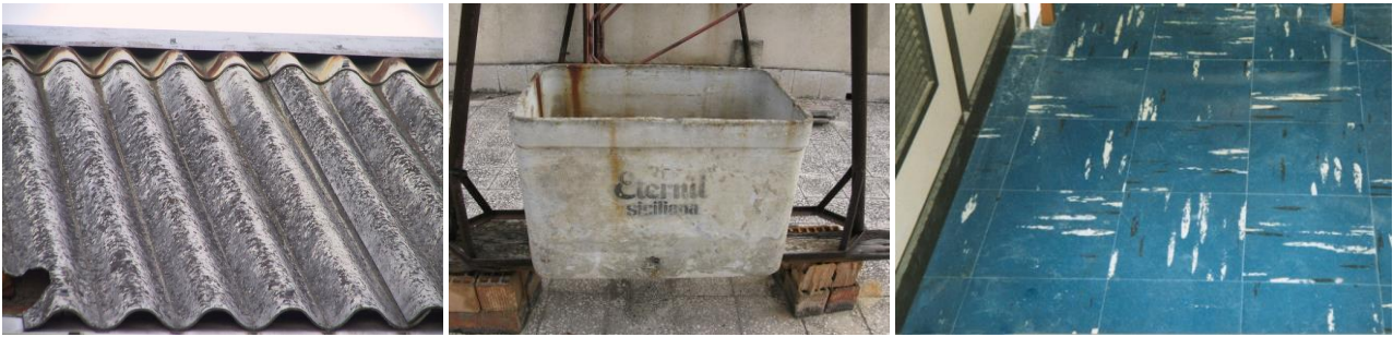
Figura 5, 6, 7 – Esempi dei principali usi di amianto compatto nel settore dei materiali da costruzione. Da sinistra: lastra ondulata da copertura in cemento amianto, vasca in cemento amianto e pavimento in vinil amianto.
