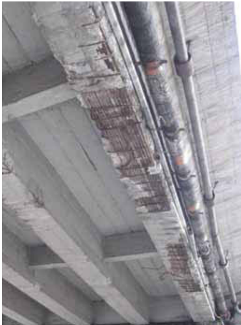
Fig. 2 - Esempio di cattivo copriferro.
