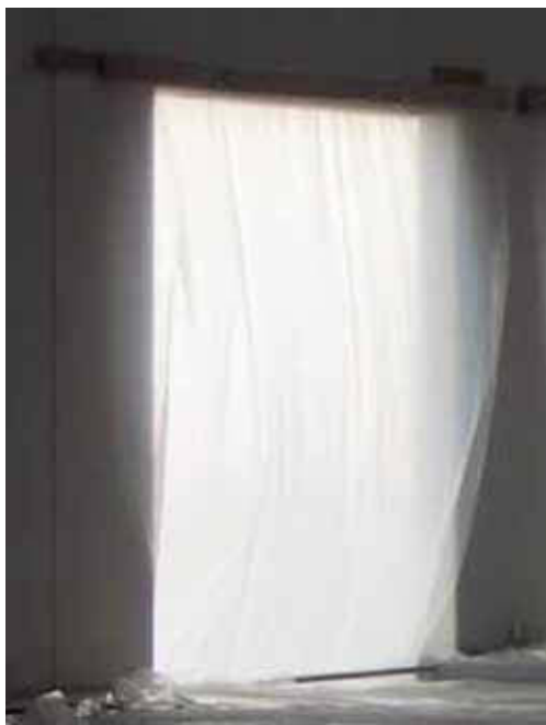
Fig. 10 – Chiusura di aperture con teli di polietilene per ridurre la ventilazione sulle superfici di una pavimentazione in calcestruzzo appena realizzata.
