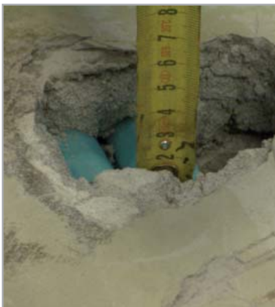
Fig. 7.6 - Spessore inadeguato di massetto sopra le tubazioni (<2,5 cm)
