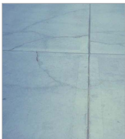
Fig. 3.3 - Disseso da "curling" in fase avanzata
