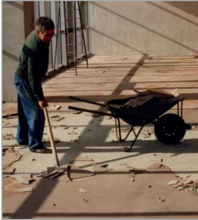
Fig. 7.10 - Distacco di ULTRAPLAN applicato su massetto con bleeding
