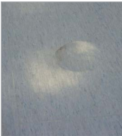
Fig. 7.5 - Sfondamento del massetto sotto la pavimentazione in corrispondenza del passaggio di tubazioni
