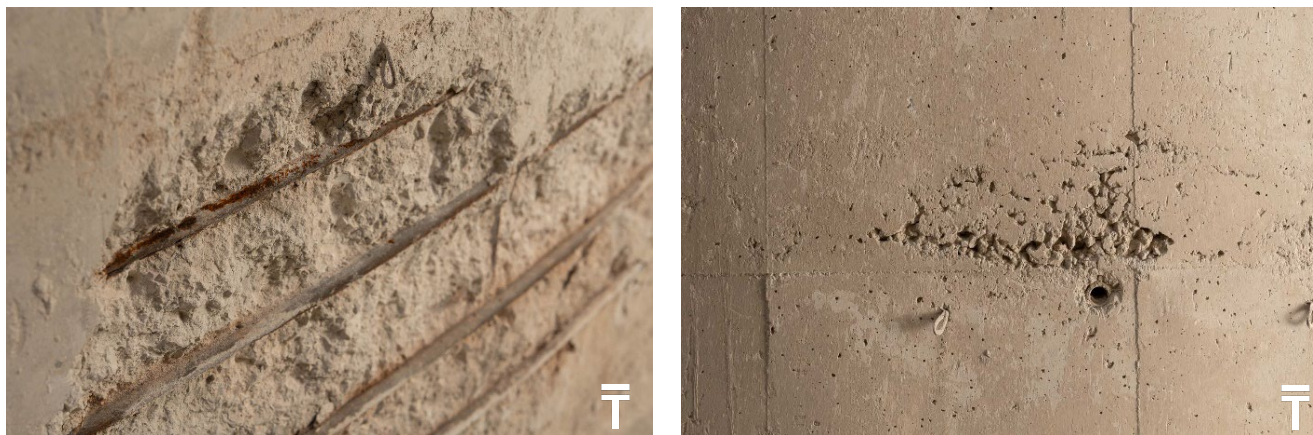
(a) (b) Figura 1a e 1b. Degrado di elementi strutturali in cemento armato: a) Struttura degli anni '50 - espulsione del copriferro e corrosione delle armature lisce; b) Nido di ghiaia causato da inadeguata compattazione.
